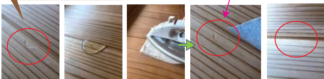
大きな凹み傷
