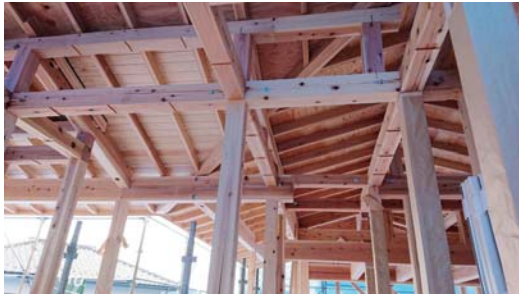
平屋の和風建築で化粧の柱や梁が多く、しっかりと組み上げられました。
