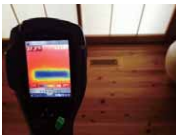
床下から冷気が出ているのが確認出来ました。 (水色の部分が温度の低い部分です)
